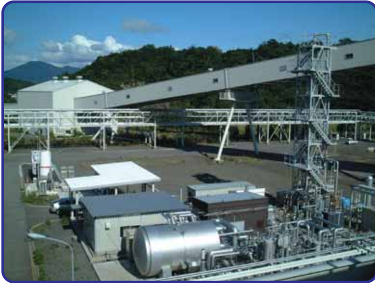
50kW 級 MCFC による CO 2 回収システム (中国電力)
