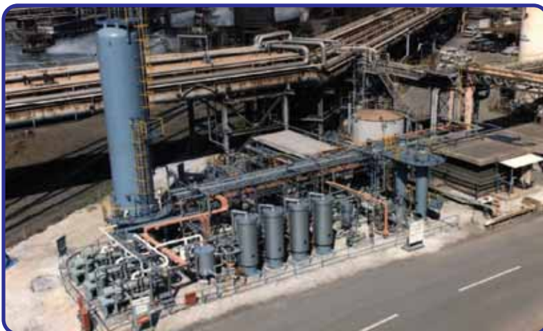
CO - PSA プラント (神戸製鋼所 加古川製鉄所 設計・ 建設: 現 神鋼エンジニアリング &メンテナンス)
