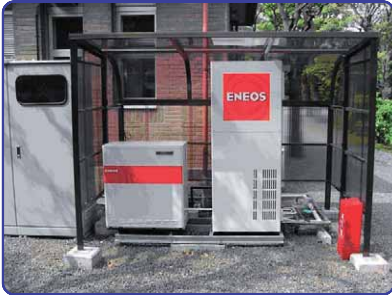
1kW 級 PEFC コージェネシステム (新日本石油)
