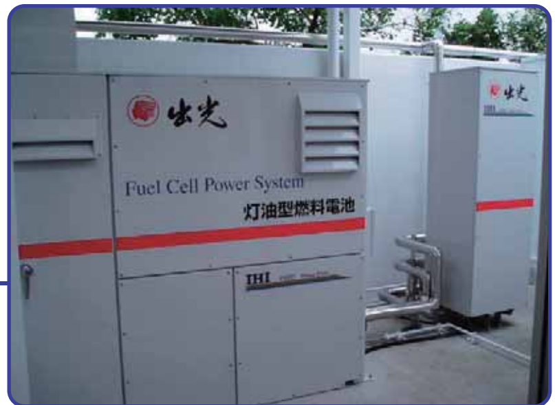
灯油型 PEFC 実証機 (石川島播磨重工業)
