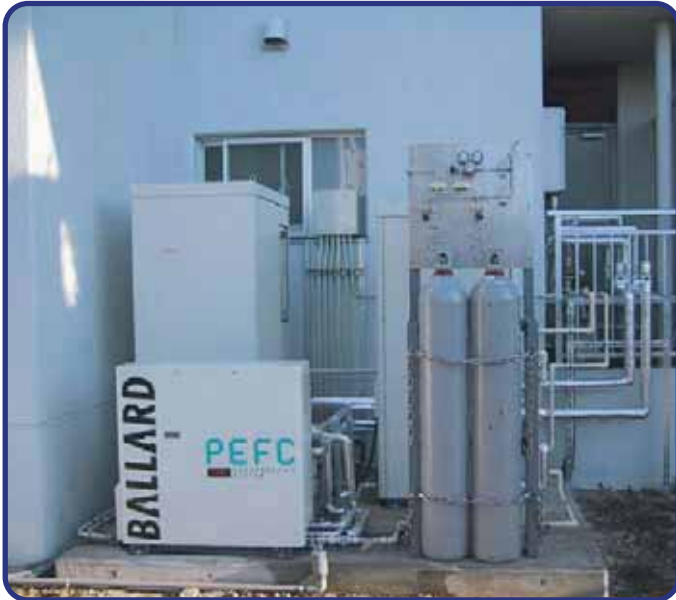
家庭用PEFCシステムの設置例 (新エネルギー財団)
