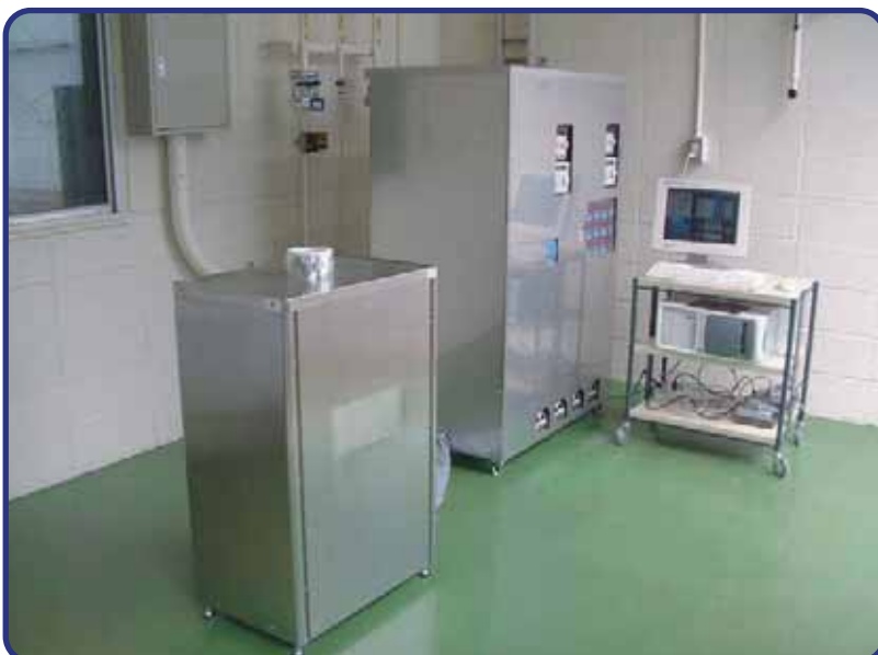
1kW級SOFC発電システム (京セラ)
