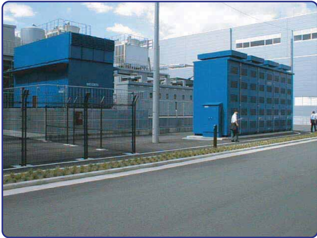
非常用電源兼用NAS電池システム（アサヒビール工場内設置：東京電力）
