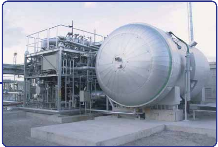
300kW級MCFC発電設備 (中部電力)
