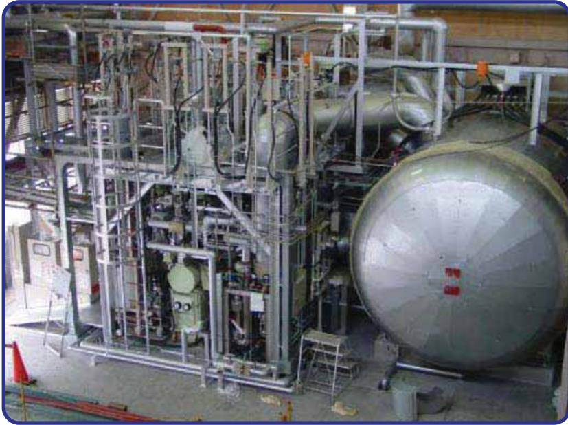
加圧小型MCFC発電システム (MCFC研究組合)
