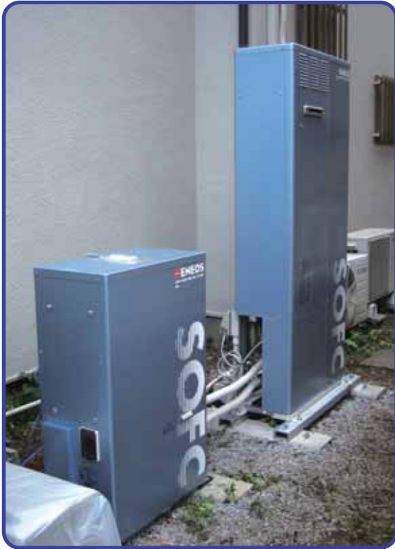
LPG 仕様の家庭用 SOFC コージェネレーションシステム (JX 日鉱日石エネルギー)
